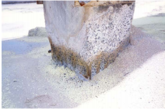
Figura 8 Ataque químico por ácido sulfúrico em pilar de indústria de fertilizantes (Fonte: AGUIAR, 2006)
