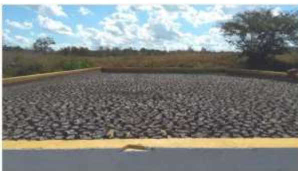
Figura 6: Leito de secagem da ETE (Fundação Escola Politécnica, 2017).
