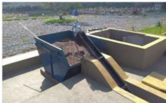
Figura 3: Sistema de caixa de areia da ETE Jacuípe II de Feira de Santana-Ba (Fundação Escola Politécnica, 2017).
