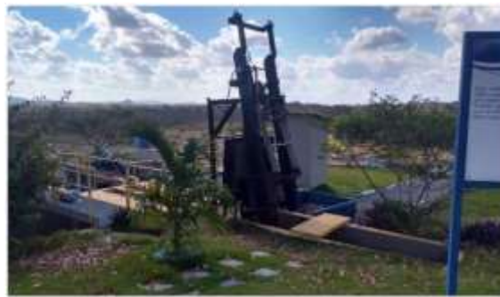
Figura 2: Sistema de gradeamento mecânico da ETE Jacuípe II de Feira de Santana-Ba (Fundação Escola Politécnica, 2017).
